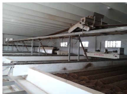
■ 生物饵料生产车间固体发酵池
